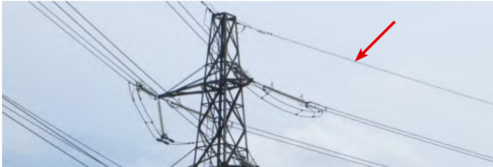
Topplinorna (vid pilen) fungerar som åskskydd. De är direkt förbundna med ledningsstolparna medan de strömförande linorna är fästa i stolparna via stora isolatorer (vanligen av porslin eller glas), som inte kan leda ström.
