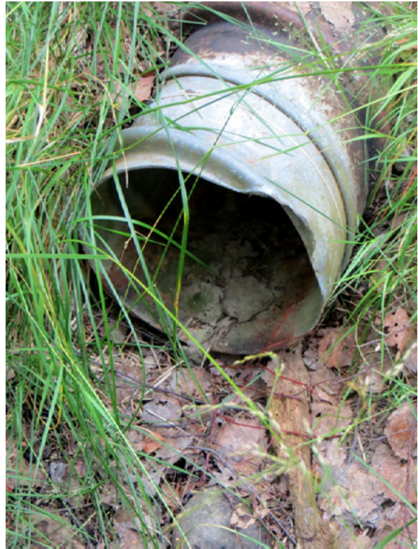
Markförlagda rör av järn måste behandlas så att de inte rostar. Det här röret har också en förstärkande spiralstruktur på utsidan.
