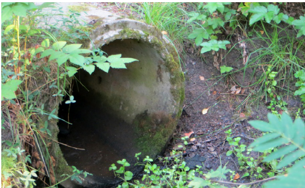
Ett betongrör som leder bort vatten för att förhindra översvämning i ett dike.
