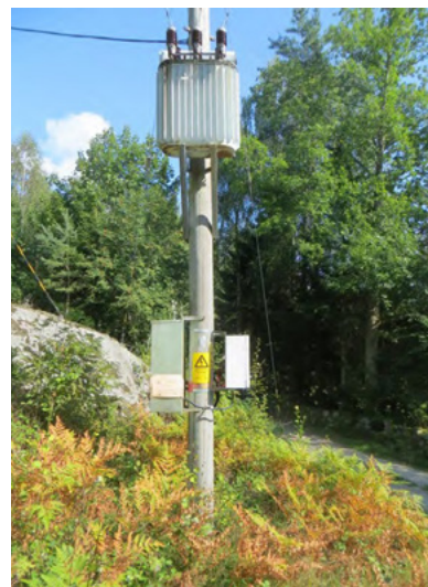
På landsbygden kan det hända att transformatorn är monterad fritt i en stolpe. Här sitter även kabelskåpet på stolpen.
