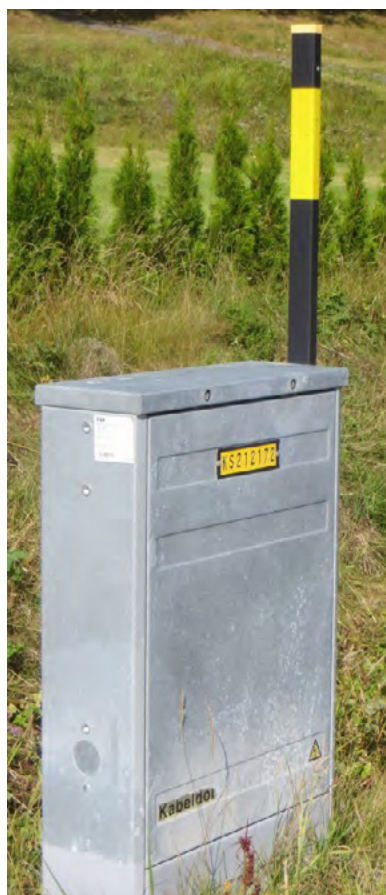
Skåp för telefonledningar eller fiberkabel.
