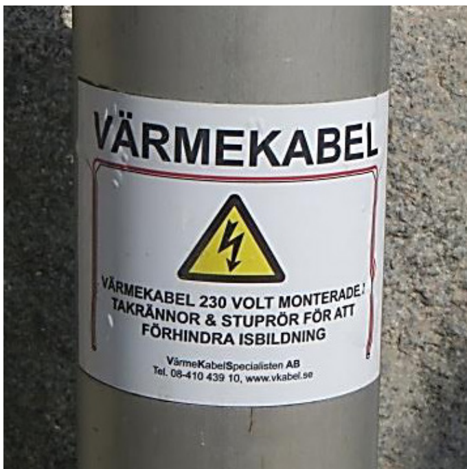
Inuti röret finns en värmekabel som hindrar att vattnet fryser.
