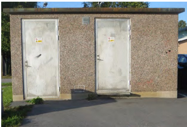
Ett transformatorhus i ett bostadsområde. Bilden visar ett vanligt utseende, men de kan också se helt annorlunda ut.
